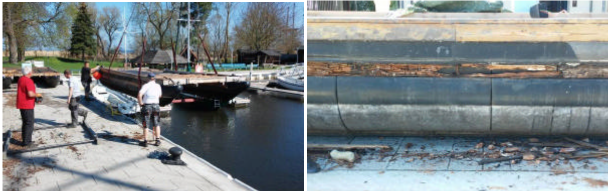
Abb: Schäden in der Unterkonstruktion bewirkten umfassenderen Sanierungsbedarf als gedacht
